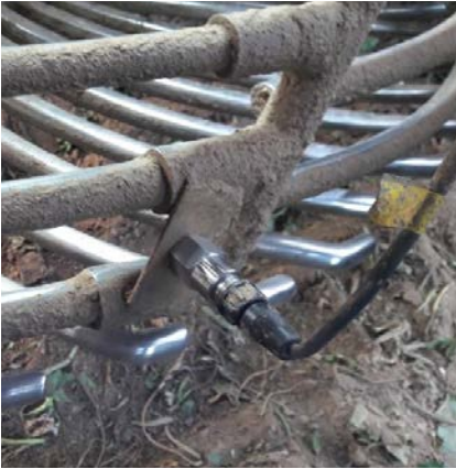
Abb. 4: Anbringung eines Akustik-sensors am Leitrost des Siebsterns.
